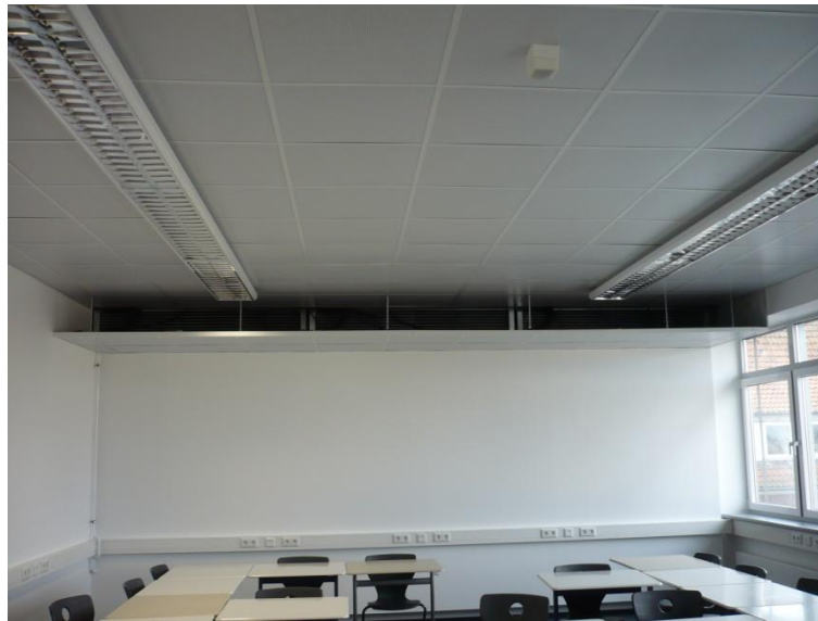
Abbildung 6-4: Foto der Kühldecke in Raum 319
