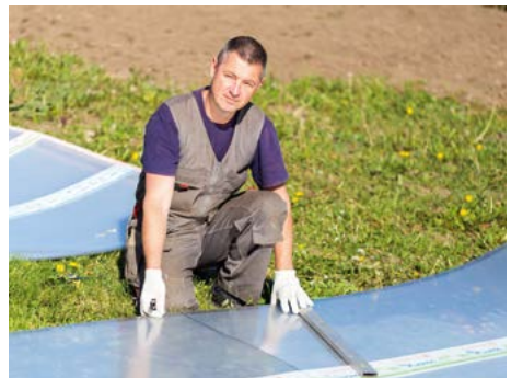
Hier fehlt insbesondere der Kopfschutz mit Hut und Sonnenbrille.
