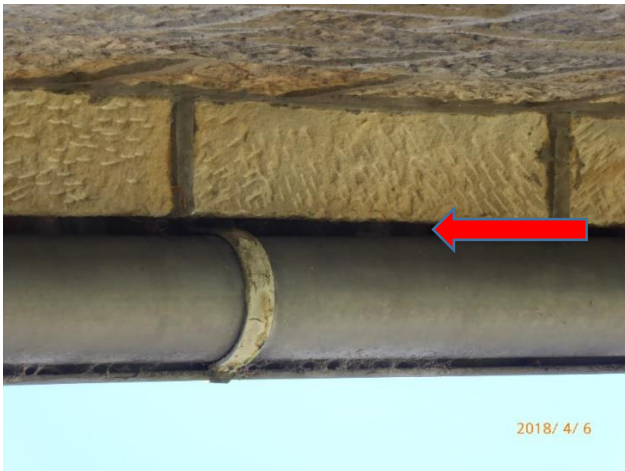
Foto 13: Wohnhaus Kümperweg 45, ca. Bau-km 1+718, Spalten zwischen Hauswand und Dachrinne, Aufnahme 06.04.2018
