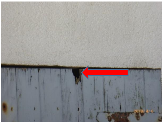
Foto 16: Wohnbaugrundstück Kümperweg 45, Nebengebäude, ca. Bau-km 1+700, Einflugloch in der Giebeltür, Aufnahme 06.04.2018
